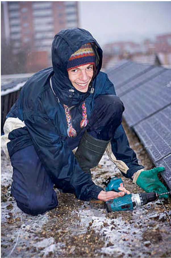
Jonas Rosenmund bei der Installation der Photovoltaikanlage auf dem Primarschulhaus Margelacker in Muttenz im Dezember 2009.
